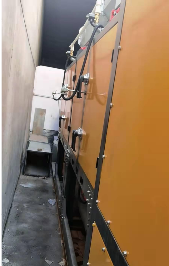
活性炭吸附+脱附+催化燃烧装置
