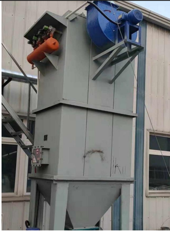
配料工序布袋除尘器
