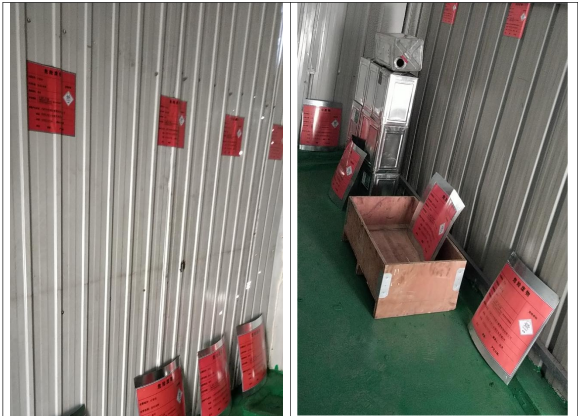
危废间内部情况
