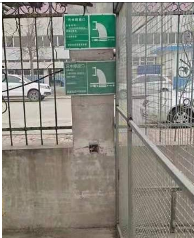
废水排放口及标识牌
