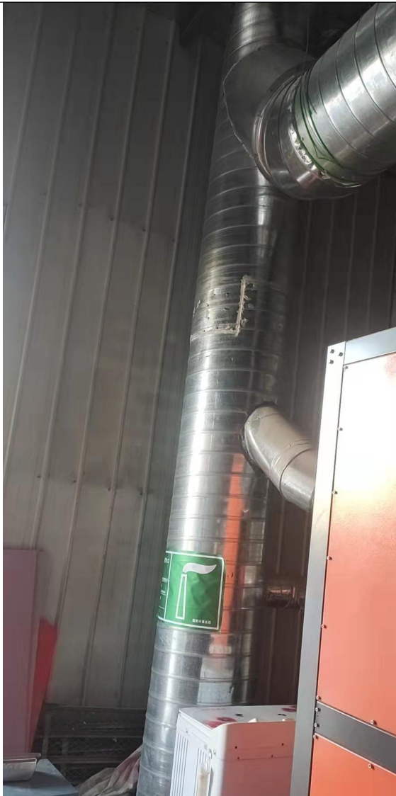
P1 排气筒及标识牌（废气合并位置）
