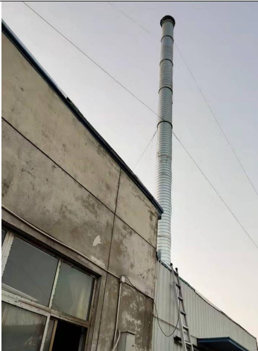
P1 排气筒（20m）
