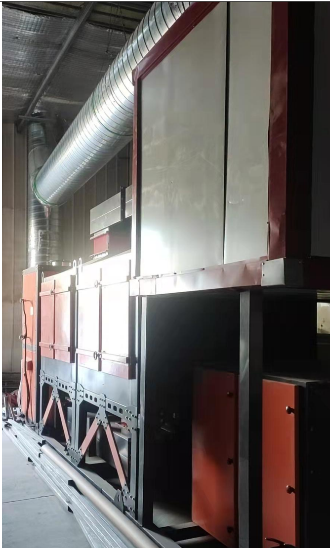
过滤棉+活性炭吸附-脱附催化燃烧装置
